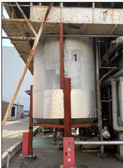
1号加熱混合タンク
