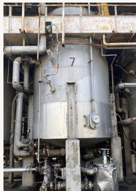
7号加熱混合タンク
